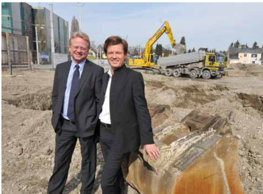
Dir. Markus Sturm („Die Salzburg“) und Vizebürgermeister Martin Panosch waren sich beim Lokalausgensein auf der Baustelle einig: „Hier entsteht soziale Infrastruktur wie wir sie brauchen. Ein Vorzeigeprojekt für die ganze Stadt!“
